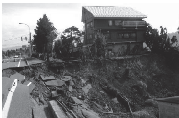
【写真】一見して危険と判定される宅地
